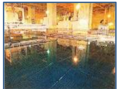
燃料貯蔵プール インターネット掲載画像を引用
